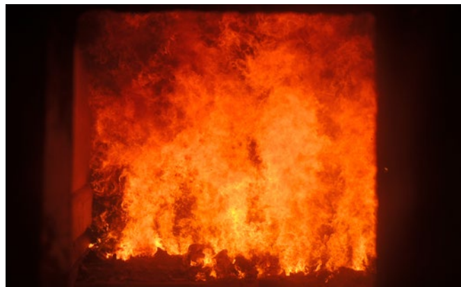
Fot. 10. Komora spalania odpadów
