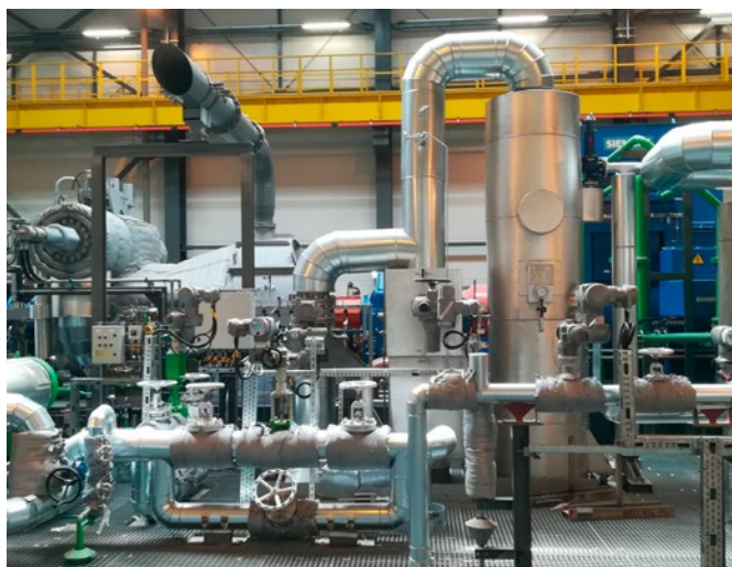
Fot. 9. Instalacje pary technologicznej w hali maszynowni
