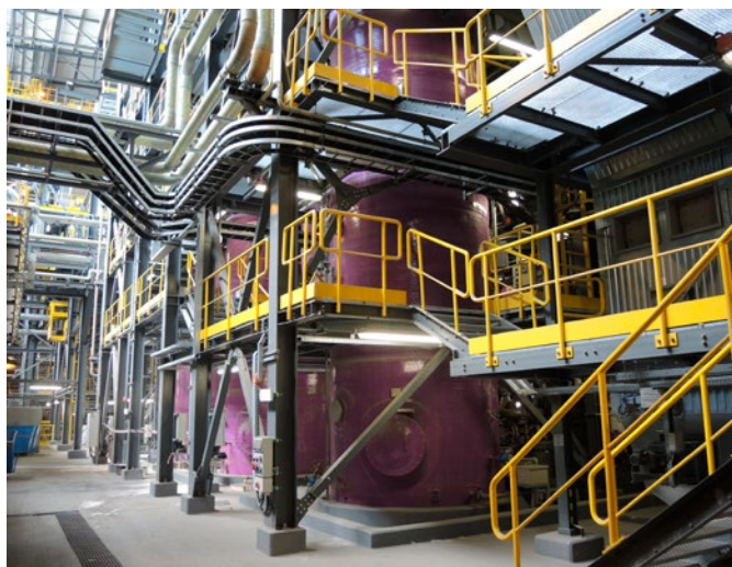
Fot. 7. Absorbery instalacji oczyszczania spalin w hali głównej
