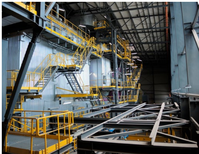
Fot. 8. Elektrofiltry ciągu technologicznego
