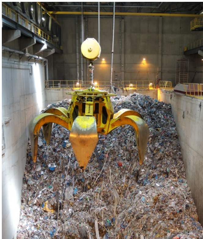
Fot. 5. Zawieszony chwytak odpadów do transportu z bunkra wydunkowego do komory spalania
